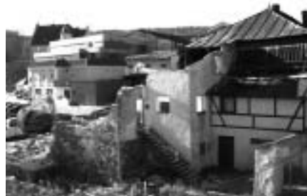
Eine Zeitrafferkamera hat den Abriss des Anbaus des Ortingerhauses im vergangenen Jahr dokumentiert.
